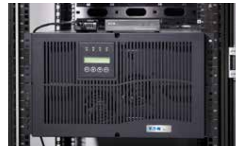
Sonda de monitoreo ambiental y Monitor de rack ambiental montados encima del UPS Eaton
