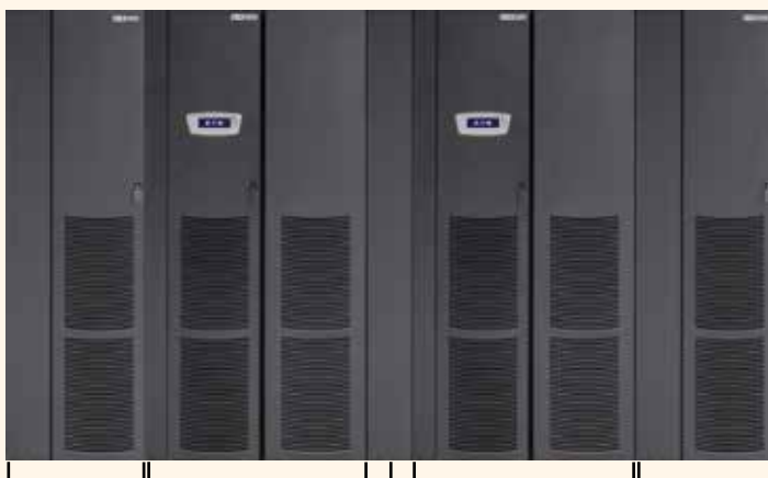
Batería 160 kVA Gabinete 160 kVA Batería Módulo UPS de unión Módulo UPS
